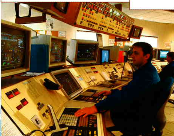
Chaque fabrication dispose d'une salle de contrôle automatisée.
